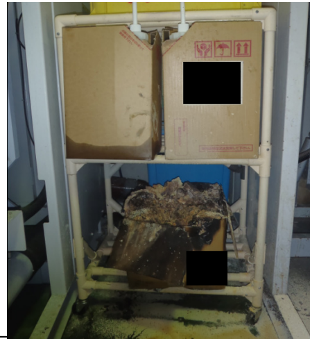
写真1 火災時の状況
